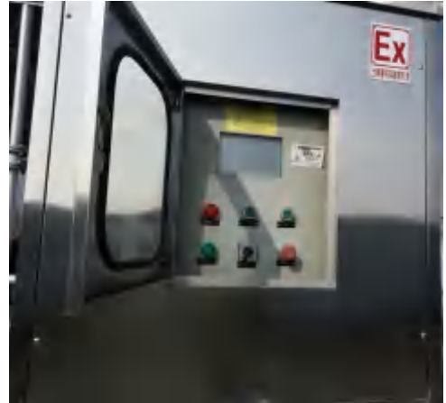
图 7-4 油气回收操作平台
