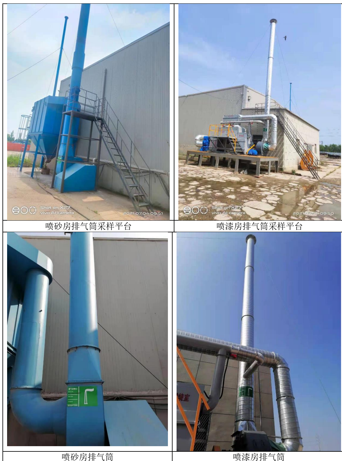
图 4-1 废气治理设施
