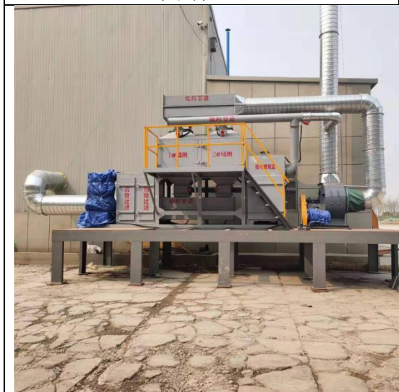
喷漆房废气处理设施
