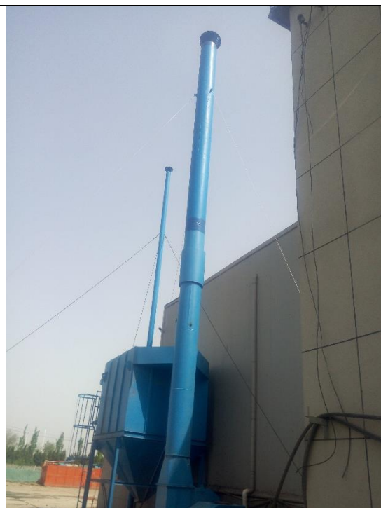
喷砂房排气筒
