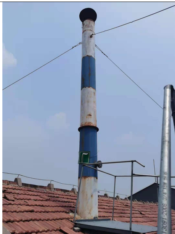
3t/h 天然气蒸汽锅炉排气筒
