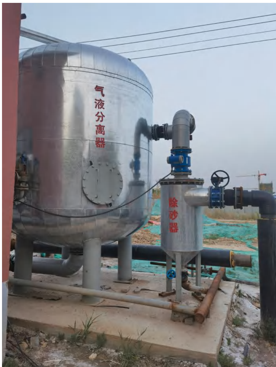
图 4.2-1 废气处理设备（气液分离器）
