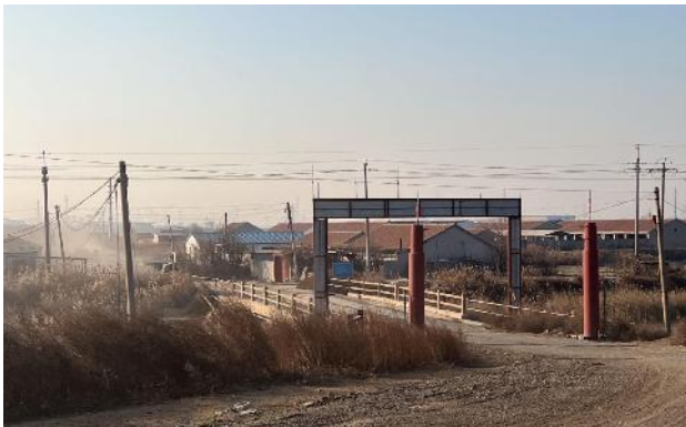
图 2-5 背水面因资金不足未铺设草皮护坡
