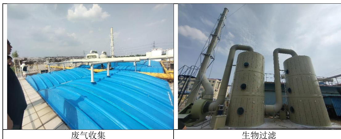
图 4-1 废气治理设施
