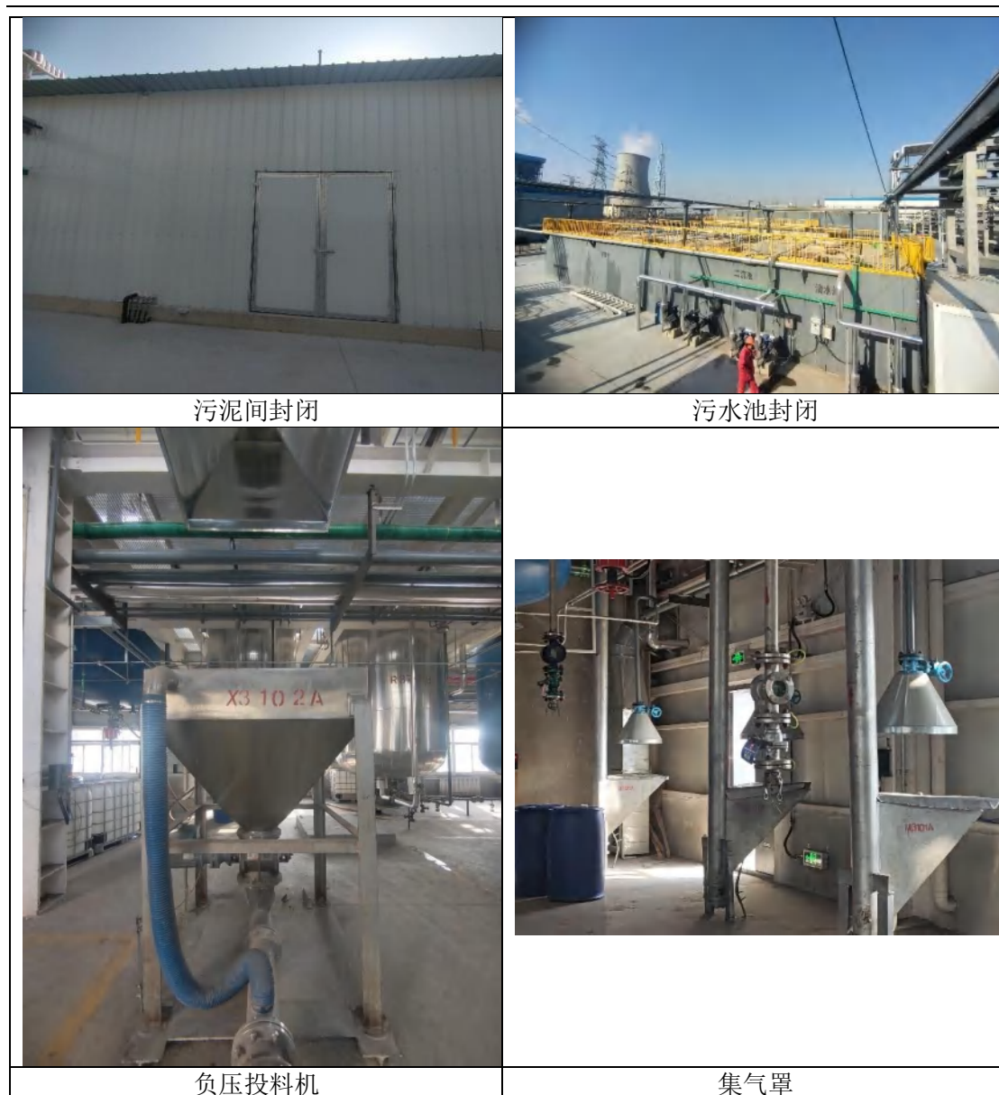
图 4.1-2 废气治理设施
