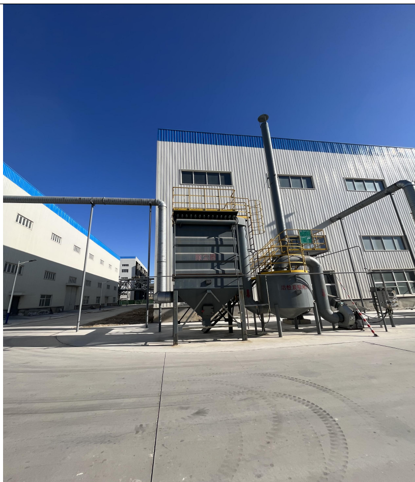
布袋除尘器+DA003
