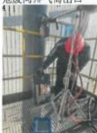
钻井液助剂车间排气筒出口
