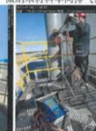
高聚物车间 2#排气筒出口
