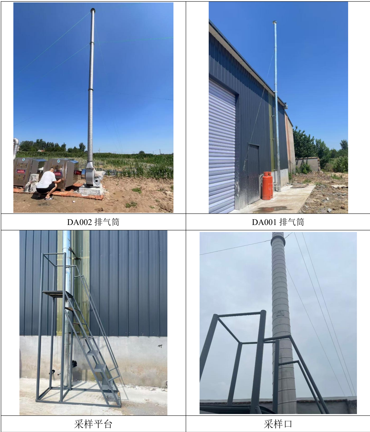
图 4.1-2 废气处理设施现场照片
