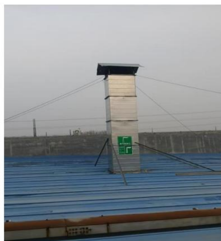
废气排放口（DA043）：
