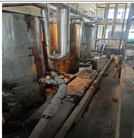
芳烃油罐及围堰
