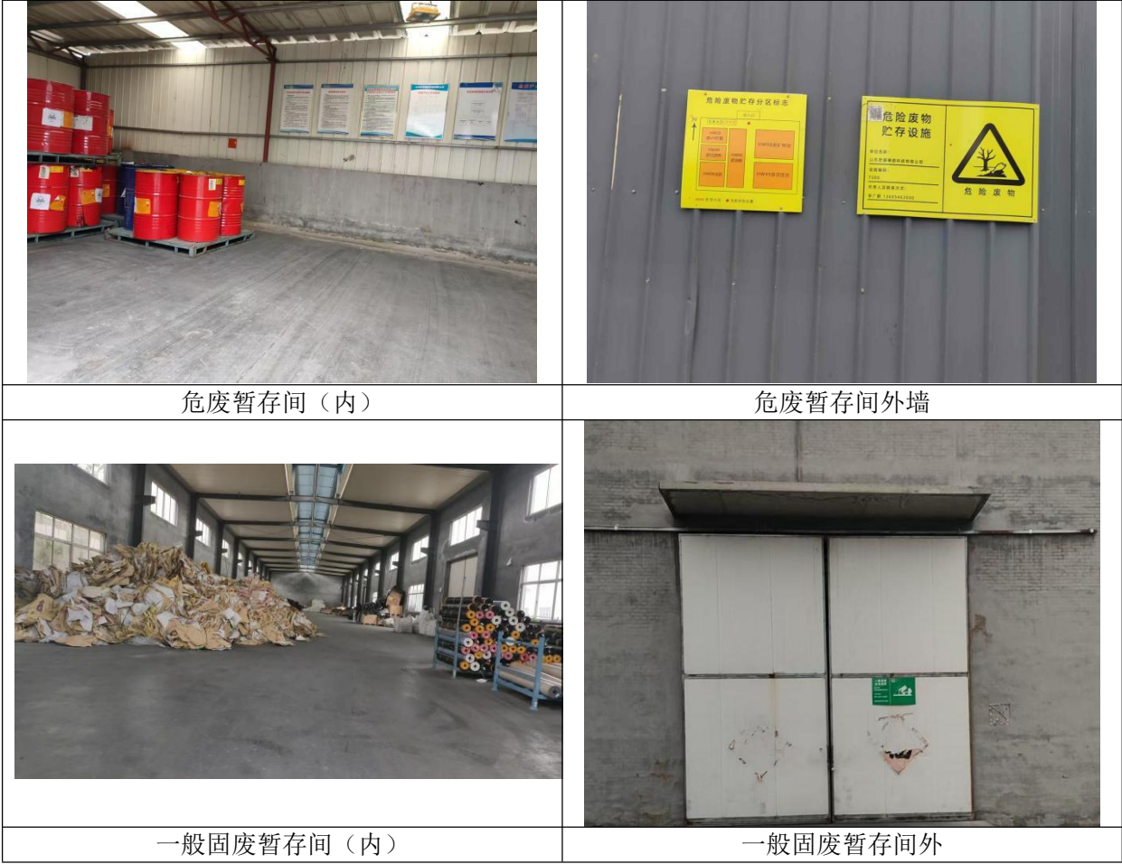
图 4.1-5 危险废物、一般工业固废贮存及污染控制措施
