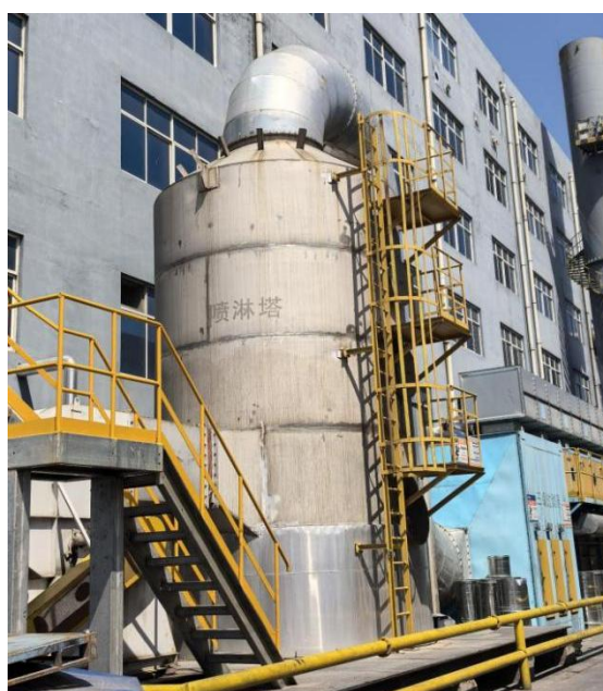
密炼废气喷淋塔
