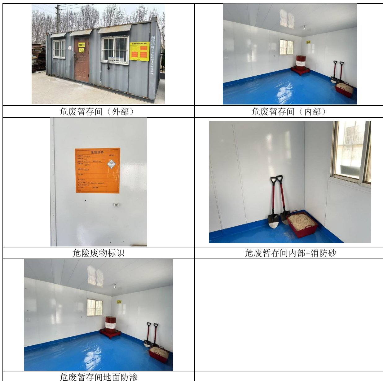
图 4.1-13 危险废物贮存及污染控制措施
